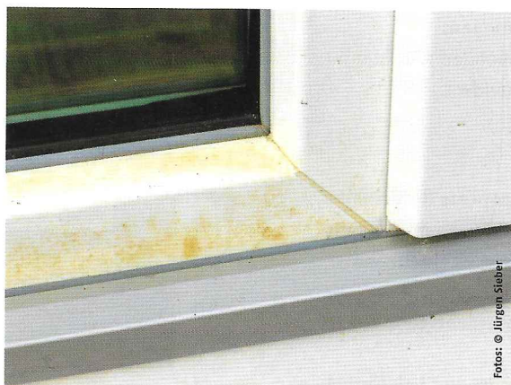
l.: Typische Gelbverfärbung an einem unteren Flügelprofil eines Kunststofffensters. Die Gelbverfärbung endet seitlich an den Schweißnähten.
